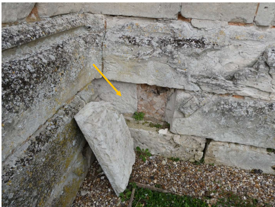
Parement pierre dégradé en soubassement
