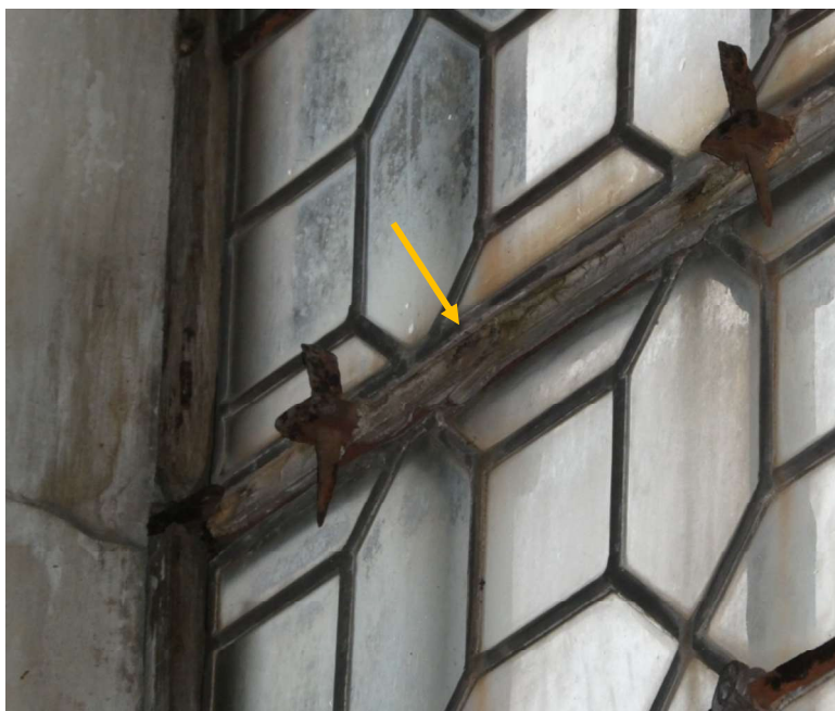
Détail de l'assemblage des panneaux sur les barlotières : absence de feuillard
