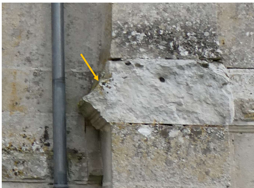
bandeau mouluré saillant cassé sur contrefort
